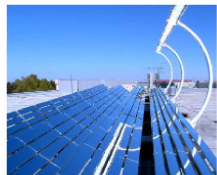
Fig.6.19: eine kombinierte Wärme- und-Strom-Solaranlage von Heliodynamics.
