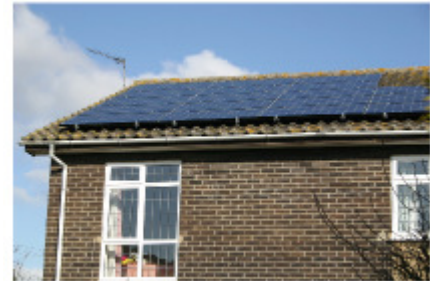
Fig.6.5: Photovoltaik: Ein 25 m 2 Modulfeld in Cambridgeshire aus 2006. Als Spitzenleistung liefert dieses Feld etwa 4 kW.
