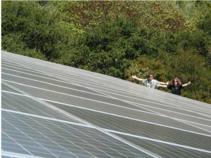
Fig.6.6: zwei Sonnenkämpfer genießen ihre PV-Anlage, die ihre Elektroautos und ihr Heim versorgt. Das Feld aus 120 Modulen (jedes 300 W bzw. 2,2 m 2 ) hat insgesamt eine Fläche von 268 m 2 , einen Spitzen-Output (vor Wechselrichter-verlusten) von 30,5 kW und einen mittleren Output – in Kalifornien nahe Santa Cruz – von 5 kW (19 W/m 2 ). Foto mit freundlicher Genehmigung von Kenneth Adelman www.solarwarrior.com
